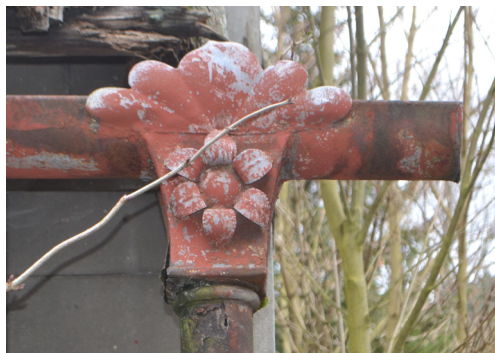
Obr. 14.: Bublava č. p. 129 – detail kotlíku dešťového svodu. [Zdroj: Dominika Výšková (fotograf), 2024].
